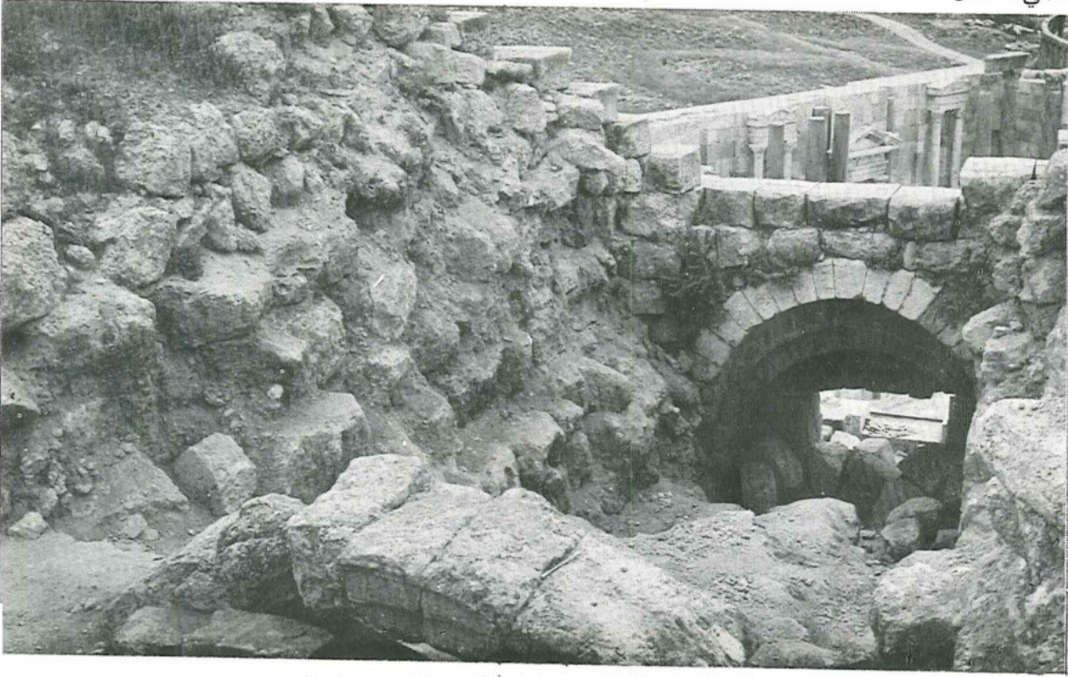
جرش : المدرج الجنوبي منظر للقبو المنهار قبل الترميم
