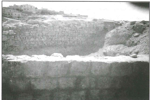
٢. ترميم الجدران المنهارة.
