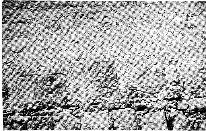
ج - طبقة القسارة التي تغطي الواجهة الداخلية للسد .
