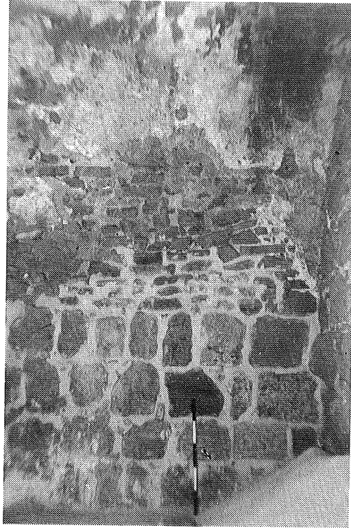
أ- الجزء المبني حديثا في الزاوية الشمالية الشرقية من صالة الحمام الزجاجل.
