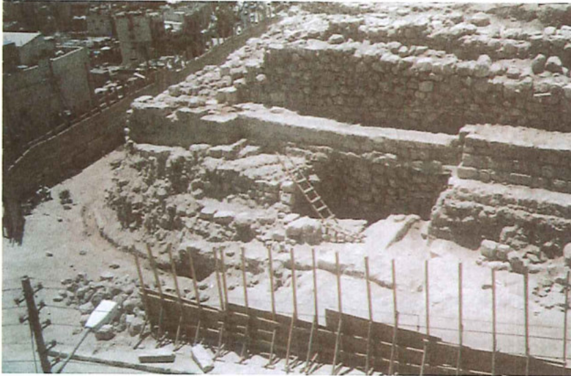
أحد الجدران قبل الترميم
