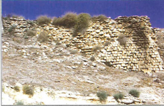
السور الداعم للبرج الشرقي قبل الترميم
