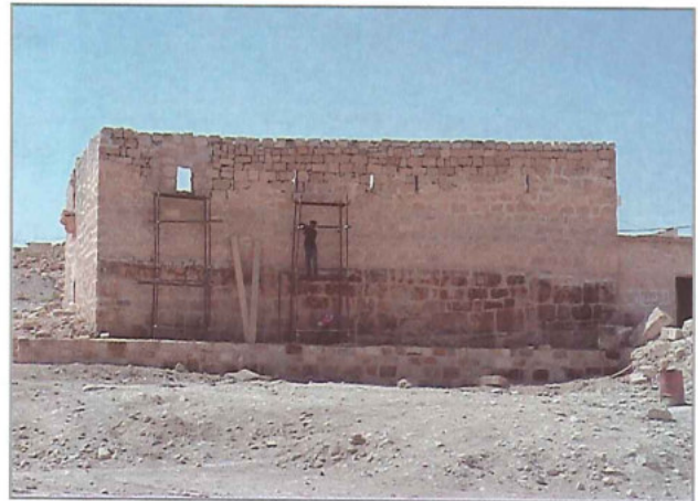
القلعة من الخارج اثناء الترميم
