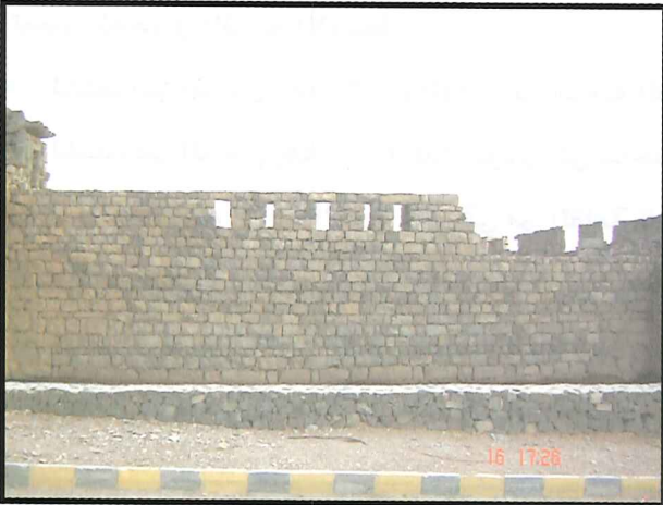
الجدار بعد الترميم
