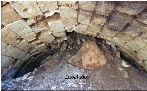
4. مكان سقوط جزء من سقف الخزان بدون تدخل.
